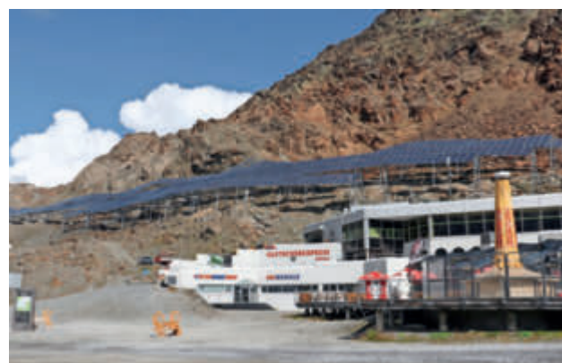
L'installation photovoltaïque des remontées mécaniques du glacier de Pitztal, en terrain découvert au-dessus de la station amont du Gletscherexpress , en fonctionnement depuis 2022, fournit près de 1.400 MWh par an.
