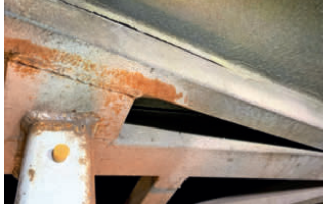
Rostschäden im Boden vor der Renovierung
