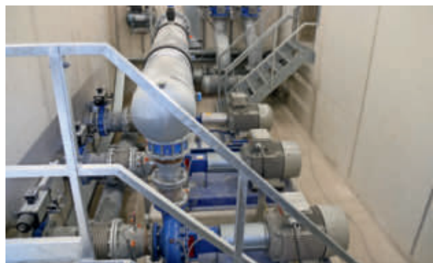
Im Zubau an die bestehende Pumpstation Seidlalm 2 wurden die Vorpumpen und der Wasserbehälter (270 m 3 ) für das Kühlsystem (rechts hinter der Wand) integriert.
