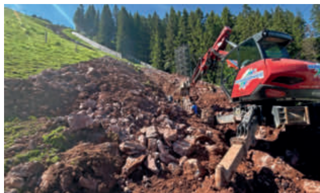
Errichtung einer 500 m langen Schneileitung in anspruchsvollem Gelände mit einem Gefälle von mindestens 70 %
