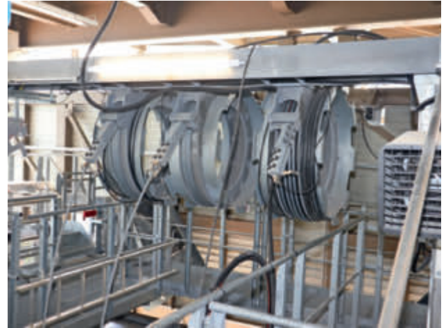
Drei Ankerpoller für die Freiluftleitungen von der Bergstation zur Talstation
