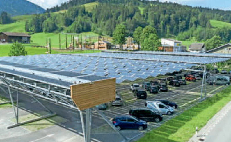
Toit solaire pliant au-dessus d'un parking dans la région d'Appenzell. Sur une surface d'environ 4.000 m 2 , soit 152 places de parking, se trouve une installation de 420 kWp.
