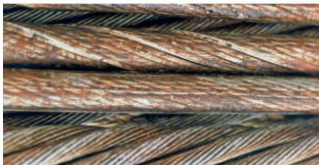
Fig. 4 : Les câbles du télésiège biplace Gefrorene Wand IIIa : en haut le câble de haubanage, en bas le câble porteur-tracteur (au niveau des longueurs de réserve)
