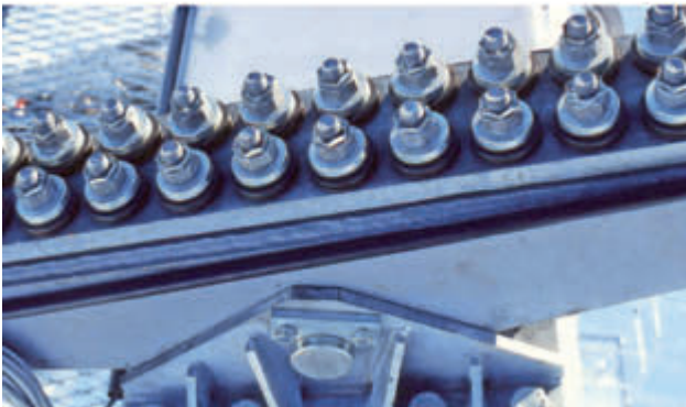
Fig. 7 : En haut : Potence du pylône en portique sur le glacier avec pince du câble de haubanage à palier tournant. En bas : les rondelles-ressorts élastiques intégrées dans les vis assurent une force de pression définie et, partant, la sécurité au glissement des pinces du câble de haubanage.
