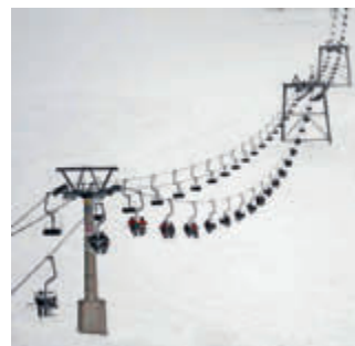
Fig. 1 : Disposition de deux pylônes portiques sur la glace, entre les pylônes ancrés dans le rocher au-dessous (à gauche sur la photo) et au-dessus du glacier (pas visible sur la photo).
