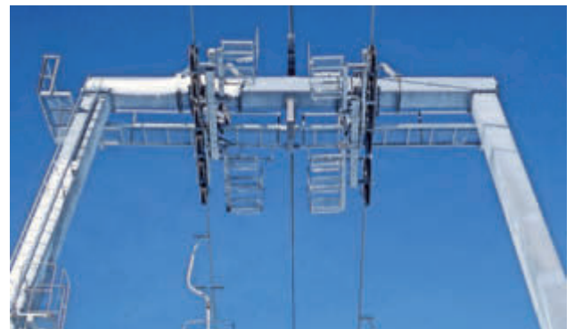
Fig. 8 : Partie supérieure du pylône sur glacier avec trains de galets du câble porteur-tracteur déplaçables sur la potence.
