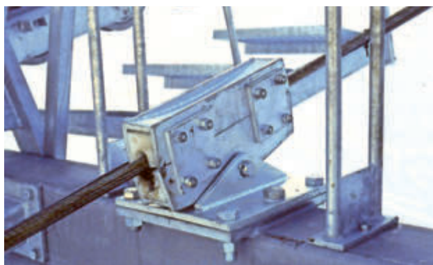
Fig. 5 : Sur les têtes des pylônes en T implantés dans le rocher, le câble de haubanage passe sur des sabots clos pivotants.
