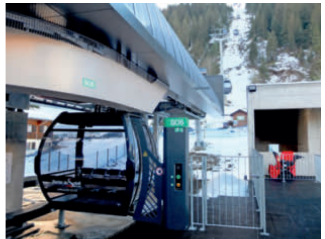
Die Ausfahrten der Stationen sind mit Konturkontrollen ausgestattet.
