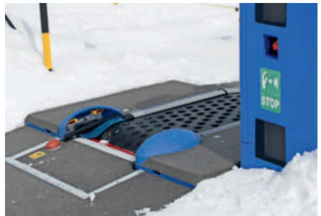
Die Antriebsstation des Förderbands Sass Runzöl : Die beiden blauen Abdeckungen der doppelten Lichtschanke der neuen Zauberteppich-Generation Type N sind so geformt, dass das Risiko eines Hängenbleibens mit Gegenständen minimiert werden kann. Rechts im Bild der blaue Schaltschrank, in dem die elektrische Steuerung i-Control untergebracht ist.
