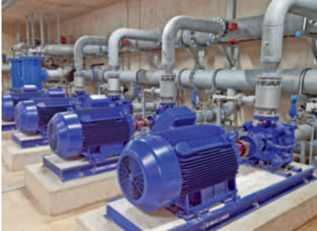
Die Infrastruktur für Beschneigungsanlagen (im Bild eine Pumpstation) kann neben der Schneeproduktion auch für die Stromgewinnung durch Wasserkraft verwendet werden.
