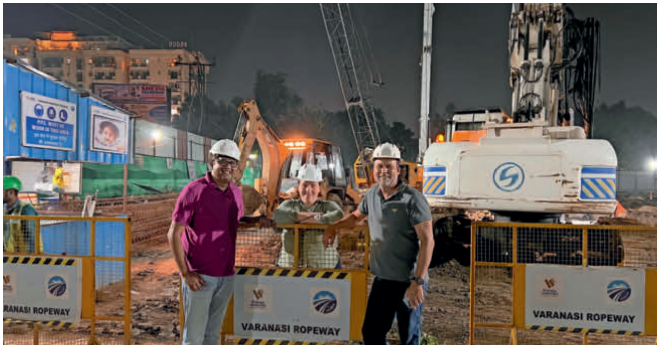
Baustellenbesichtigung in der indischen Millionenstadt Varanasi (v. li. n. re.): Mrigank Shekhar (CEO Bernard Consultants Private Limited), Marie Bach (Projektleiterin Salzmann Ingenieure) und Stephan Salzmann (GF Salzmann Ingenieure)
