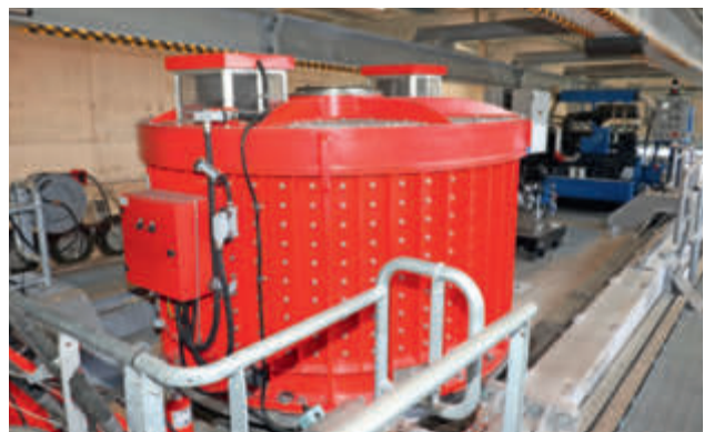
In der Bergstation wurde der 950 kW starke Direktantrieb angebracht.
