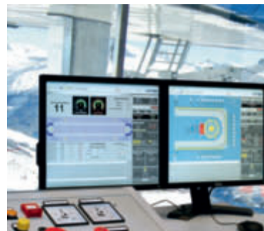
Abb. 3: Die hochauflösenden Bildschirme der SCADA-Stationen neben dem Steuerpult
