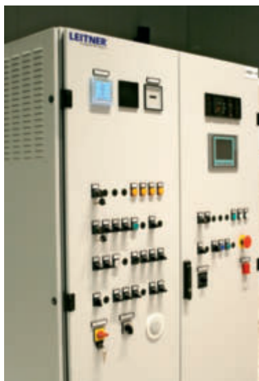
Abb. 1: Steuerschrank der Leitner-Anlagen
